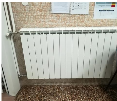
Figura 8.5 - Particolare dei radiatori esistenti
