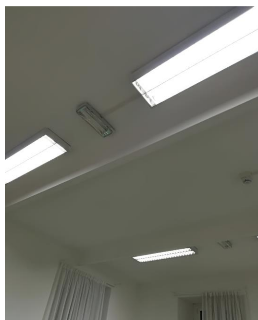
Figura 4.10 - Particolare dei corpi illuminanti ubicati nelle aule
