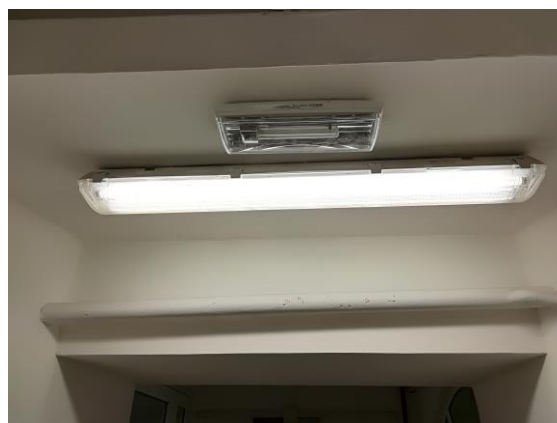
Figura 4.9 - Particolare dei corpi illuminanti ubicati nei locali dell'edificio
