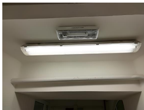
Figura 8.9 - Particolare di una lampada fluorescente attualmente installata
