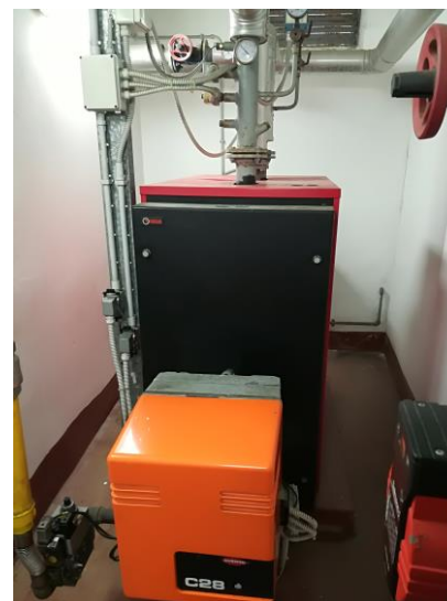
Figura 8.7 - Particolare del generatore di calore attuale
